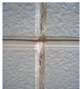
外壁劣化の現実
