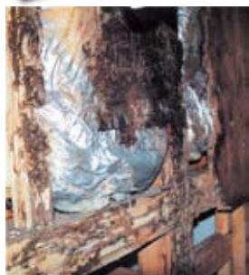
壁内結露の恐怖
